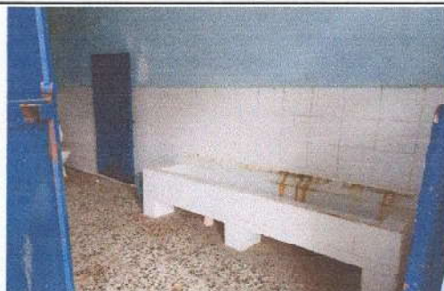
Foto 6: Orinales para hombres, en mal estado
