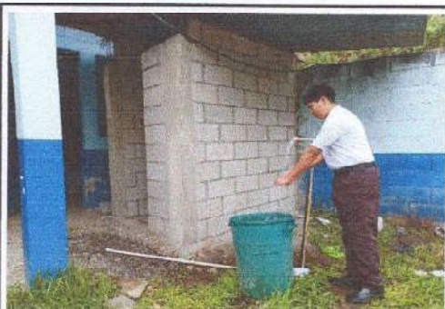
Foto 9: Carencia de una pila.
