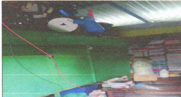
Foto 12: tendido eléctrico fuera del centro de computación
