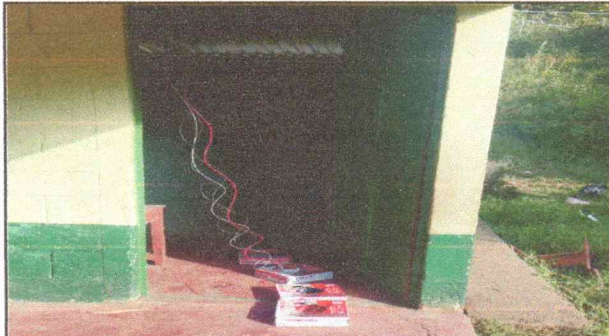
Foto10: tendido eléctrico en corredor de aulas
