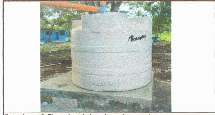
Foto: Anexo 2. Tinaco instalado en base de concreto
