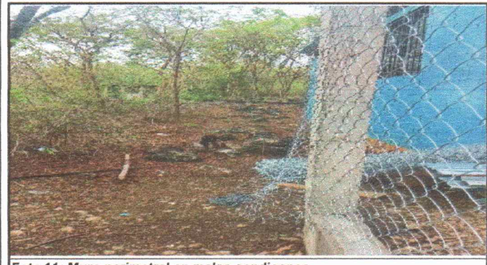
Foto 11: Muro perimetral en malas condiciones
