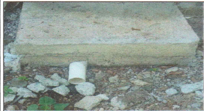
Foto 9: Tubería de drenaje en condiciones desfavorables
