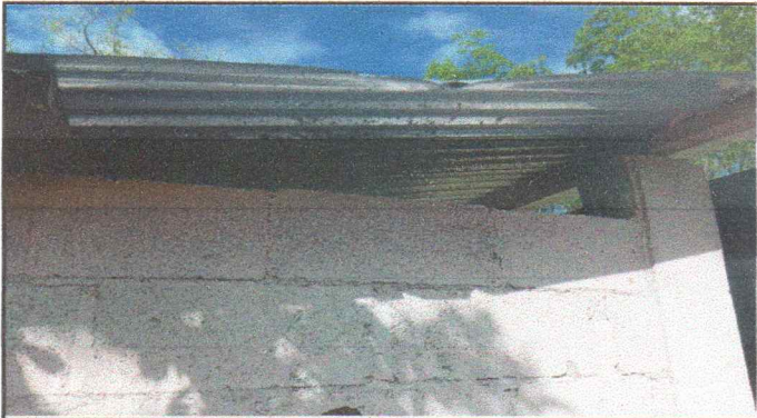
Foto1: Techo de lámina en mal estado
