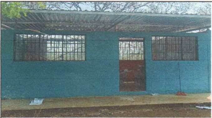
Foto 3: Muros interiores y exteriores sucios y con colores diferentes
