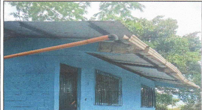
Foto 7: Canal de metal en mal estado
