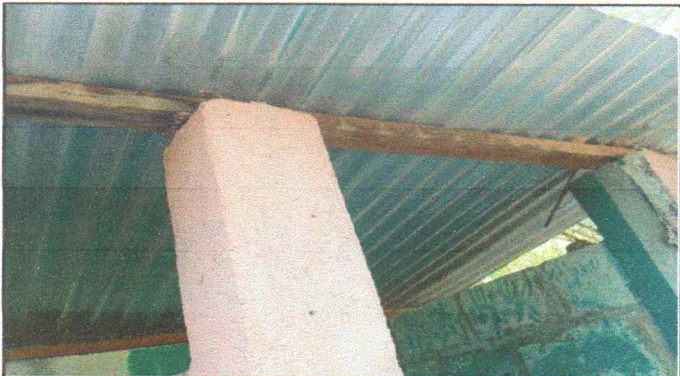
Foto 2: Soporte de madera en malas condiciones
