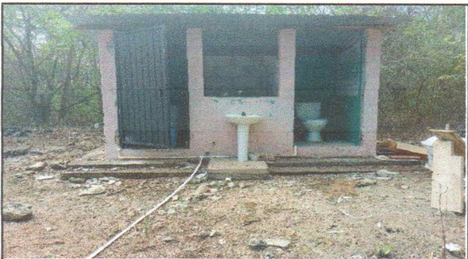
Foto 4: Servicios sanitarios sin puerta
