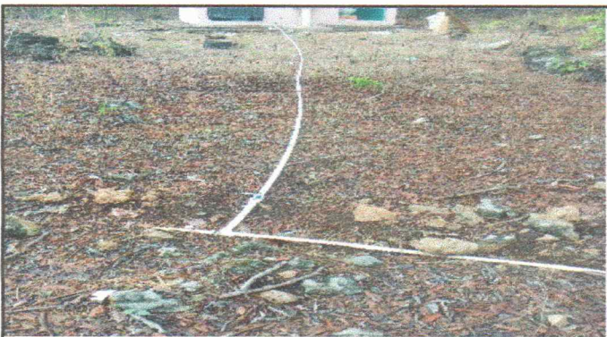
Foto 10: Mal estado en tubería de PVC línea principal
