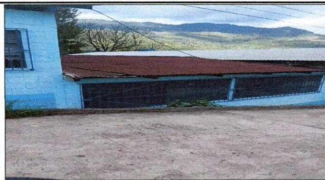
Foto 2: Techo del Instituto demasiado bajo.
