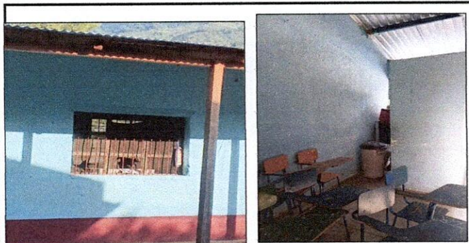
Foto 5: Balcones deteriorados, y espacios sin puertas
