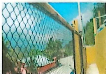
Foto 7: RENG LÓN 12. MANTENIMIENTO DE PORTONES: Estado actual del portón de ingreso al establecimiento.
