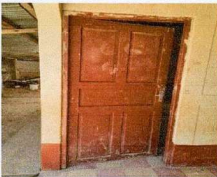
Foto 3: Puertas de madera deterioradas
