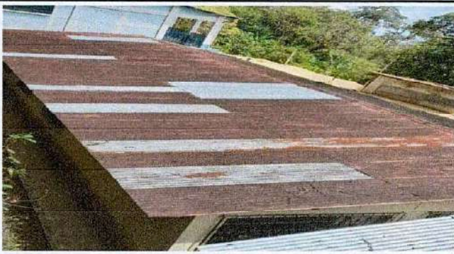
Foto1: Lámina en malas condiciones
