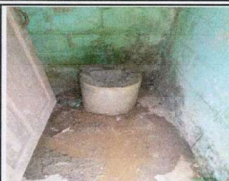
Foto 8: Inodoros en malas condiciones
