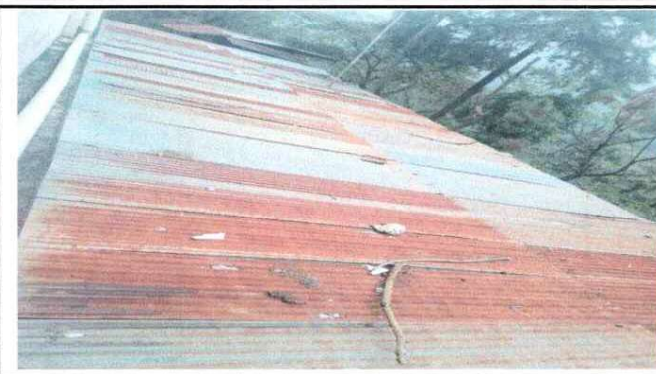
Foto 2: Lámina en malas condiciones
