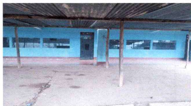
Foto 4: sustitucion de vidrios de ventanas y puertas ya que estan rotos
