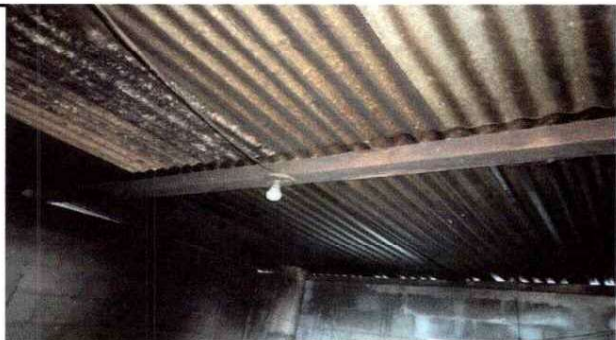
Foto 7: sustitución de focos ahorradores ya que no tiran el alumbrado
