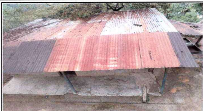
Foto1: Lámina en malas condiciones
