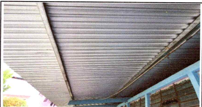
Foto 3: Sustrucion de canales frente de las aulas
