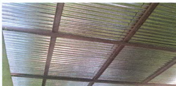
Foto 6: COSTANERAS Y VIGAS DE METAL DAÑADAS POR OXIDO ES NECESARIO SUSTITUIR.
