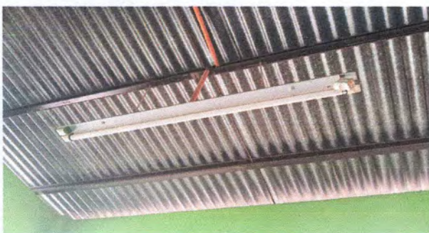
Foto 3: LÁMPARA DAÑADA ES NECESARIO SUSTITUIRLO .
