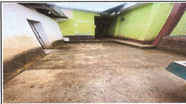
Foto 8: Torta de cemento en malas condiciones
