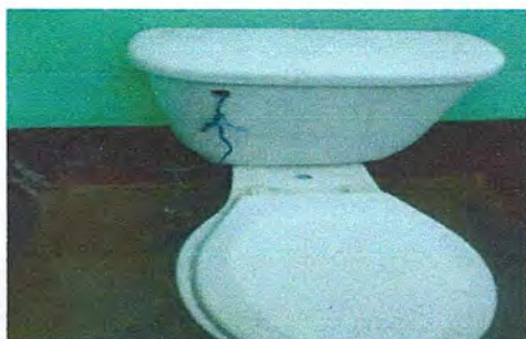
Foto 5: Servicios Sanitarios y accesorios
