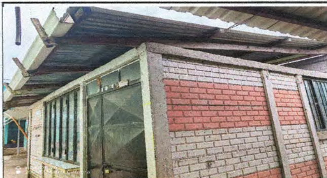
Foto 2: Estructura de techo a sustituir por metal
