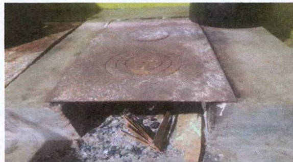
Foto 2: Sustrucción de plancha de metal de tres ornillas y chimenea de metal.
