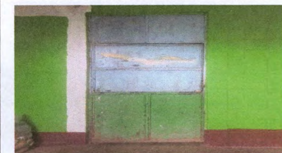
Foto 5: Sustrucción de puerta (2.10m de alto * 1.03m de ancho).
