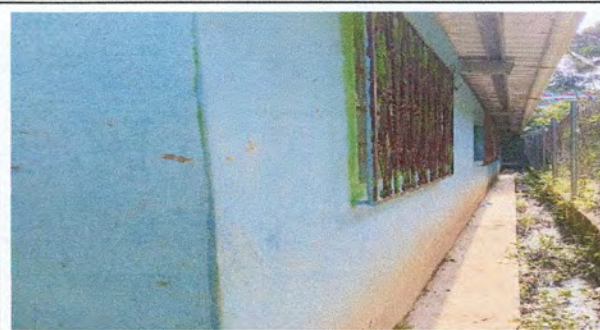
Foto 4: Sustrucción de pintura en pared del centro educativo.
