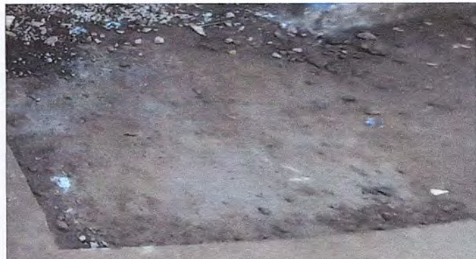
Foto 4: PISO EN MAL ESTADO
