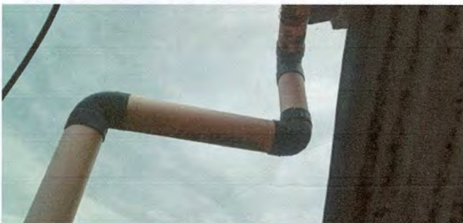
Foto 5: Bajadas de aguas puviales en mal estado
