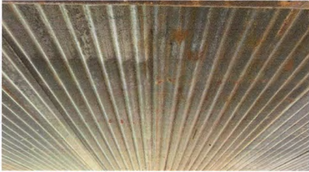
Foto1: Lámina de techo deteriorada
