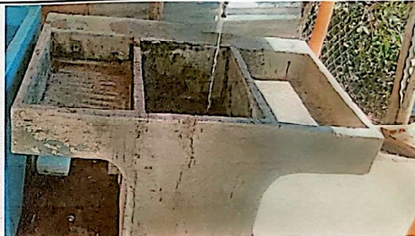
Foto 4: Pila en mal estado y sin accesorios
