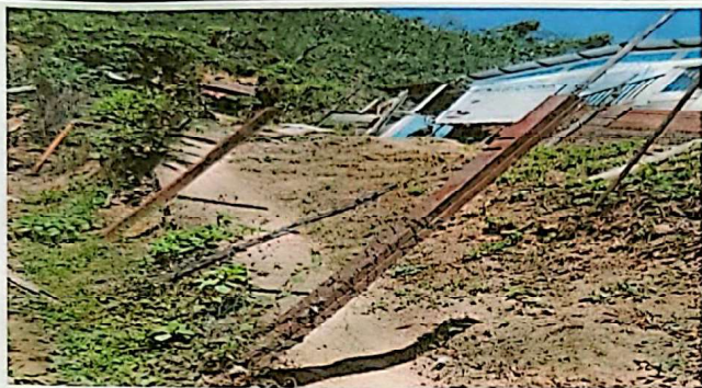
Foto 1: Malla de circulación deteriorada
