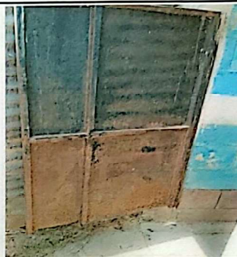
Foto 2: Puertas de baño deterioradas
