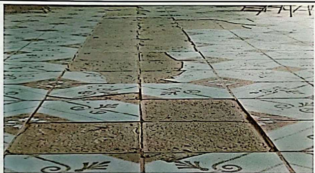
Foto 3: Piso del salón escolar en mal estado
