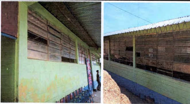
Foto 3: Marco de metal de dos aulas detereoradas y una ventana de la direccion
