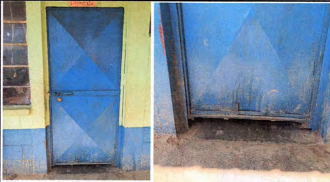
Foto 2: Puerta de dos aulas y direccion detereoradas
