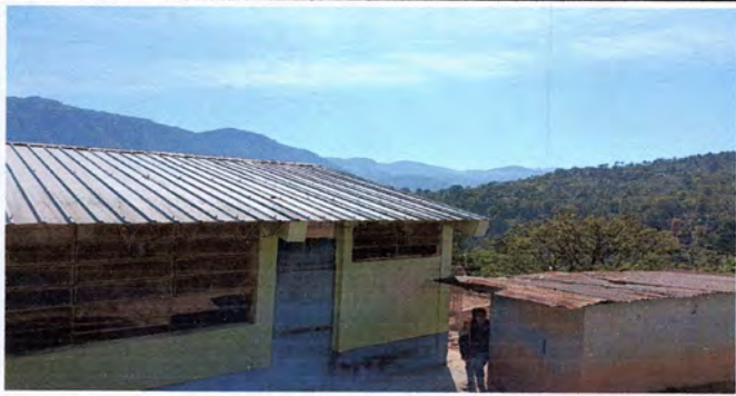
Foto1: Techo de lamina de una de las aulas perforado y mal estado
