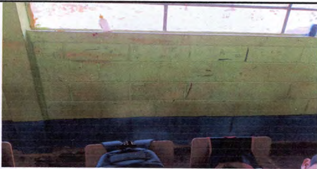
Foto 6: Paredes interiores y exteriores manchas, pintura detereorada
