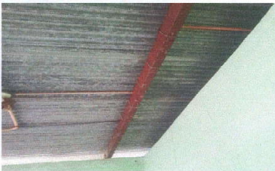
Foto 3: Ganchos de fijación en mal estado
