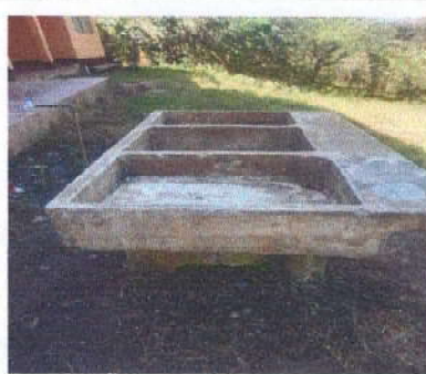
Foto 12: Pila de dos lavaderos en mal estado
