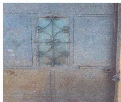
Foto 4: puertas de metal en mal estado
