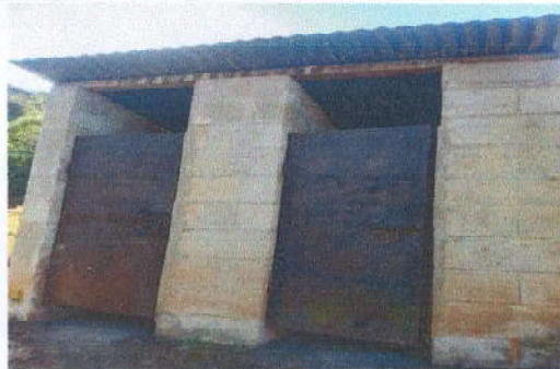
Foto 11: Servicio sanitario en mal estado en techo, pintura y piso
