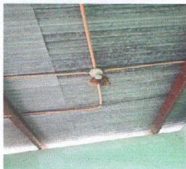
Foto 13: Focos y plafoneras en mal estado
