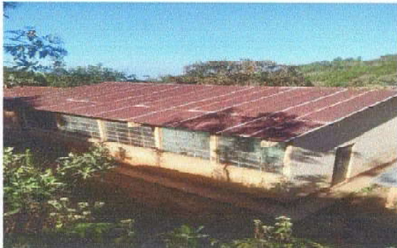
Foto1: Techo de lámina en mal estado
