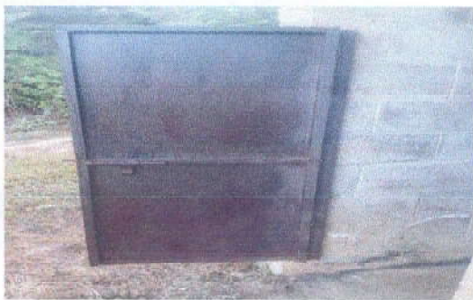
Foto 5: Puertas de sanitarios en mal estado
