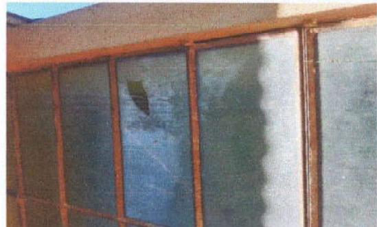
Foto 6: vidrio de ventana en mal estado
