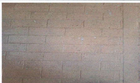
Foto 10: Pintura en interior y exterior en mal estado
