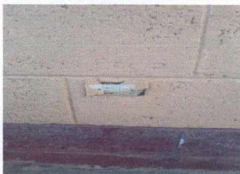
Foto 15: Tomacorrientes en malas condiciones
