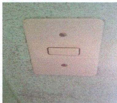
Foto 14: Interruptores en mal estado
