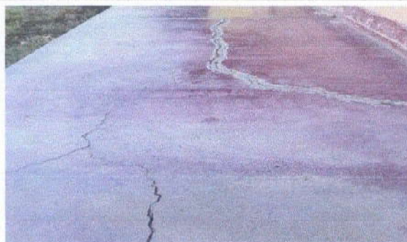
Foto 8: Piso en mal estado exterior e interior del aula
