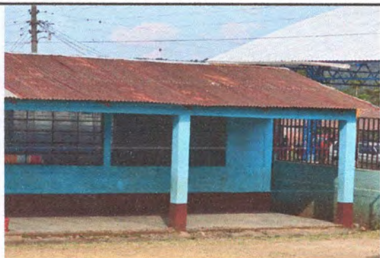
Foto 3: Sustrucción de capote de cubierta de lamina
