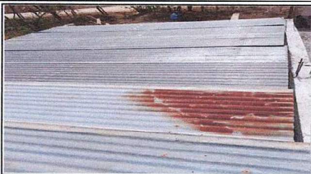
Foto 1: Cubierta de lámina que se va a cambiar.
