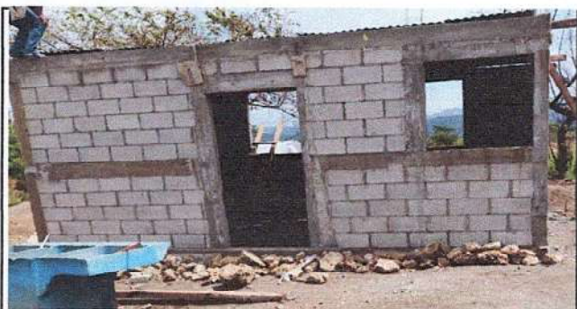
Foto 3: Puerta de cocina.
