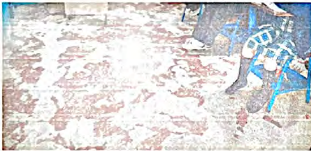
Foto 3: Piso en malas condiciones
