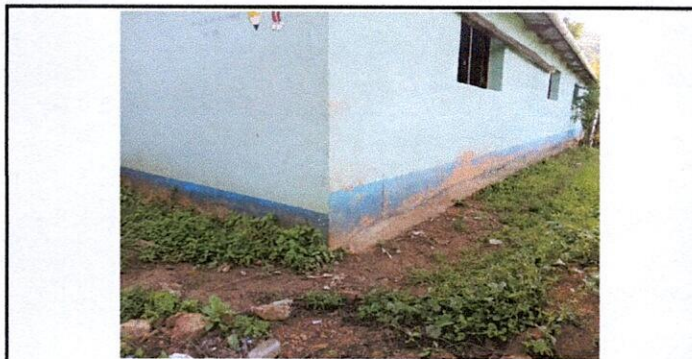
Renglón 5: Cuneta de concreto en mal estado
