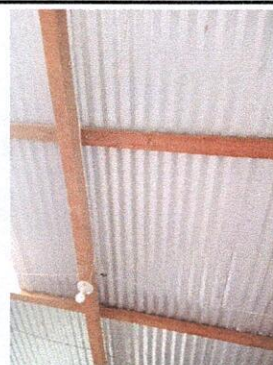
Renglón 11: Sistema eléctrico necesita reparación
