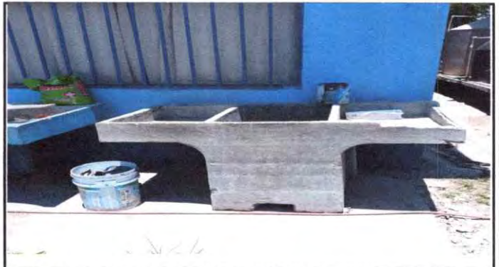
REGLÓN 7 DEPÓSITOS DE AGUA: SE SUSTITUIRÁN DOS PILAS DE CONCRETO DE DOS LAVADEROS. UNA SE COLOCARÁ EN LAS AULAS NUEVAS Y LA OTRA DONDE SE OBSERVA ESTA PILA DETERIORADA.
