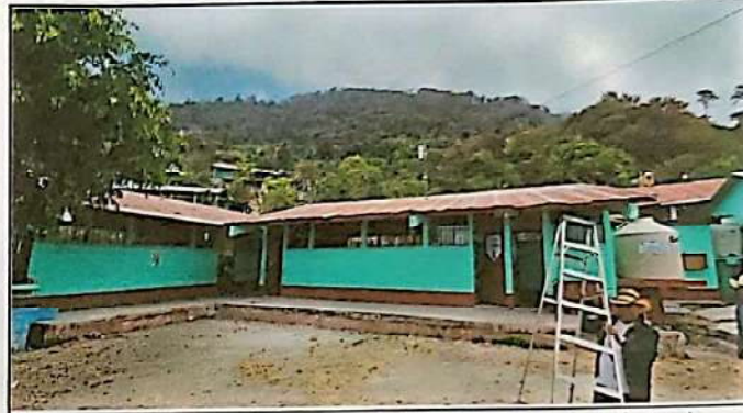
Foto 2: Una de las aulas tiene goteras no tan grandes pero si afecta el resguardo de los niños y lo que se guarda en el aula.
