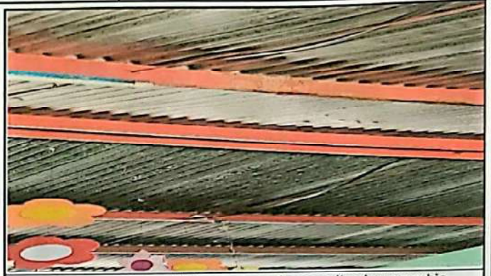
Foto 2: Hay una gotera y el detereoro se nota, necesitando un cambio.
