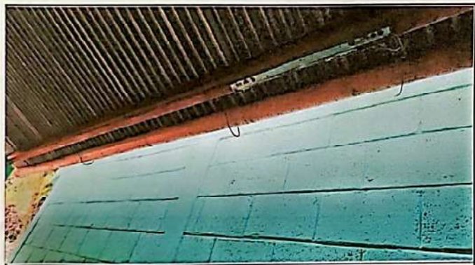
Foto 3: Para poder recaudar agua de lluvia se debe contar con tubos en buen estado.
