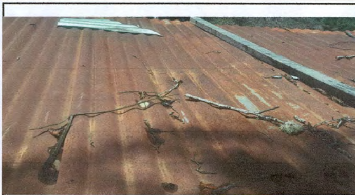
Foto1: Lamina en mal estado
