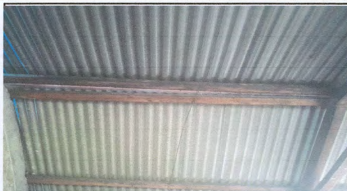
Foto 2: estructura de techo en mal estado.
