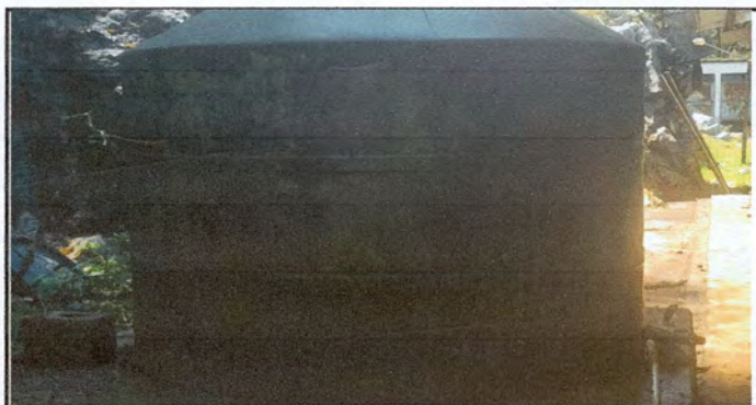
Foto 6: deposito de agua en mal estado.
