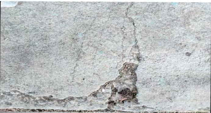
Foto 5: Piso de torta de concreto deteriorado
