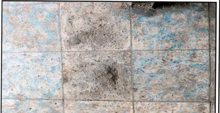
Foto 6: Piso de granito en mal estado
