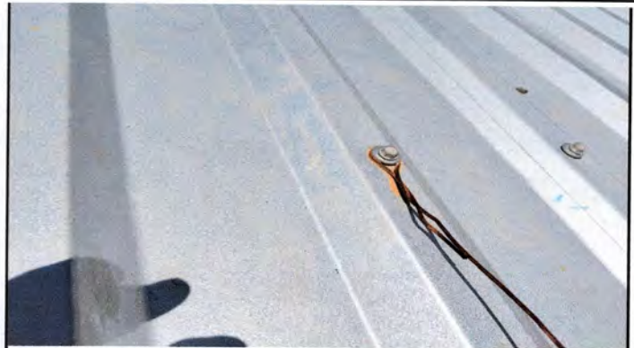
Foto 2: Elementos de fijación en mal estado
