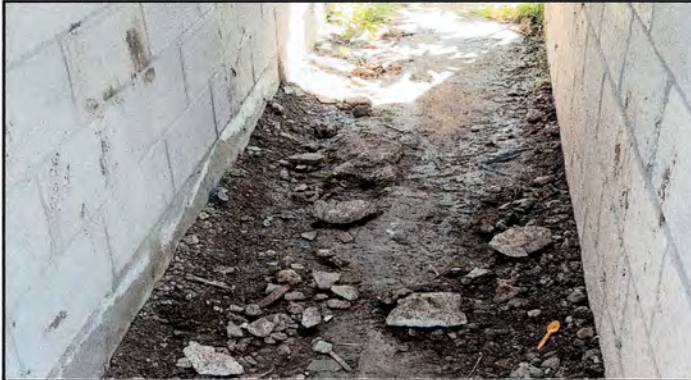
Foto 7: Cuneta de concreto en mal estado
