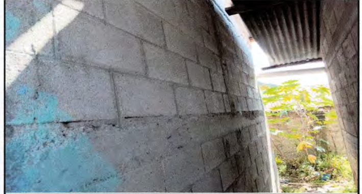
Foto 8: Pintura de exteriores en mal estado
