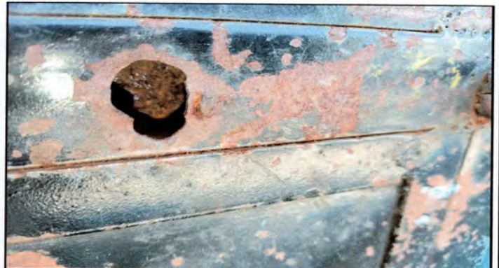
Foto 4: Puerta de sanitarios en mal estado
