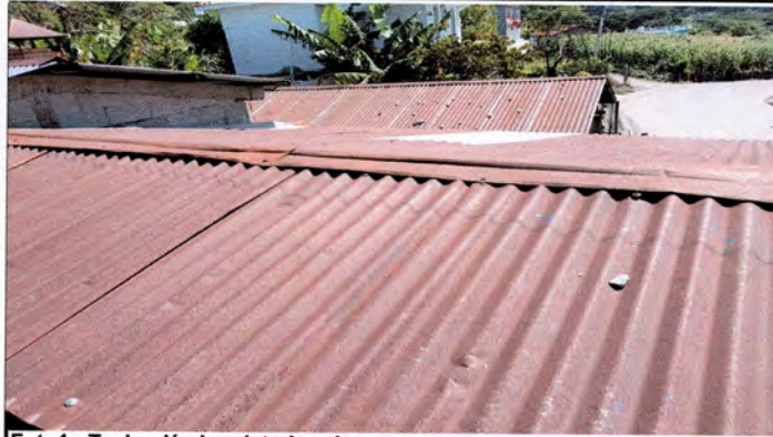
Foto1: Techo, lámina deteriorada
