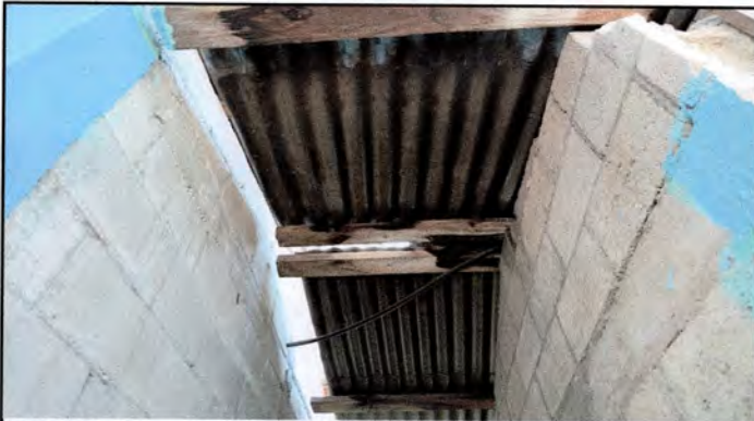
Foto 3: Soportes de madera en mal estado
