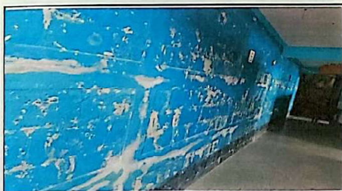
Foto: 5. Paredes despintadas y deterioradas
