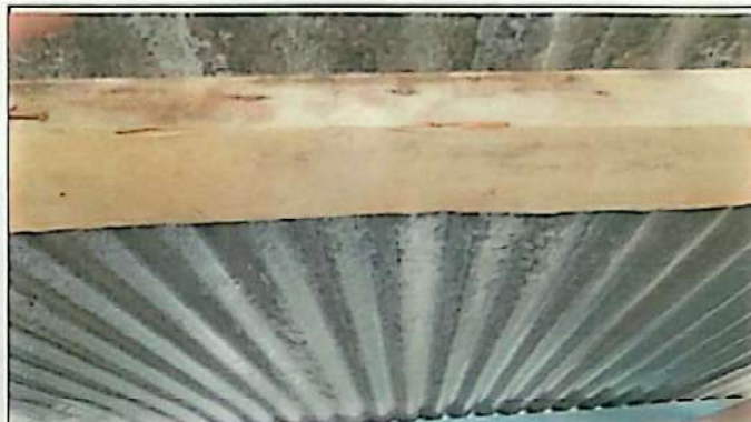
Foto :2. Soporte de techo de madera muy deteriorada
