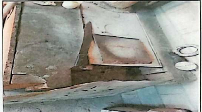
Foto : 8. Cocina deteriorada sin utensilios
