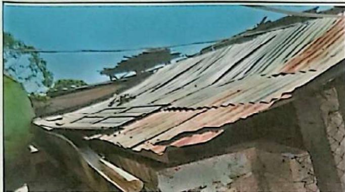
Foto:1. Techo de lámina en mal estado y elementos de fijación
