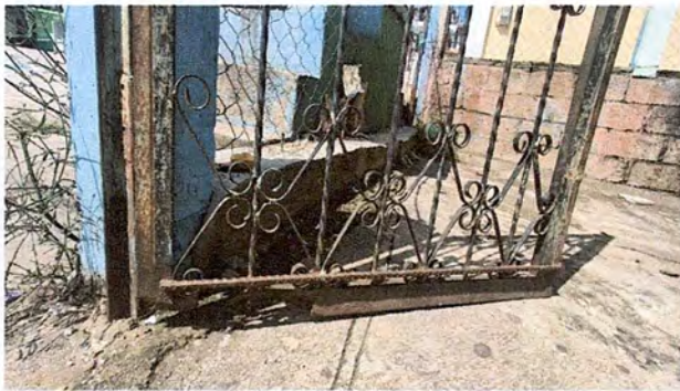
Foto 9: Portón en mal estado
