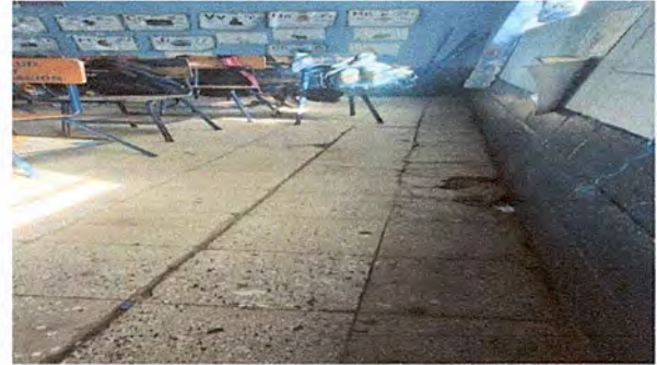
Foto 8: Piso en mal estado
