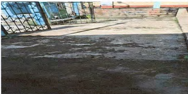
Foto 5: Piso en mal estado
