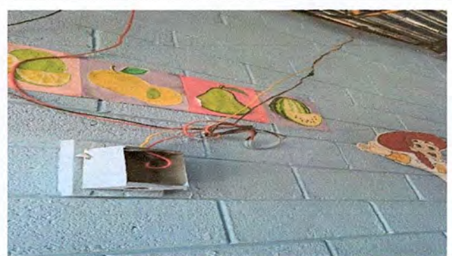
Foto 4: Instalacion de energia en mal estado
