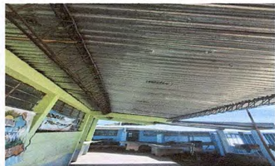
Foto 2: Soporte en mal estado
