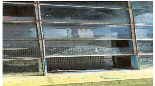
Foto 6: Vidrios de ventanas en mal estado
