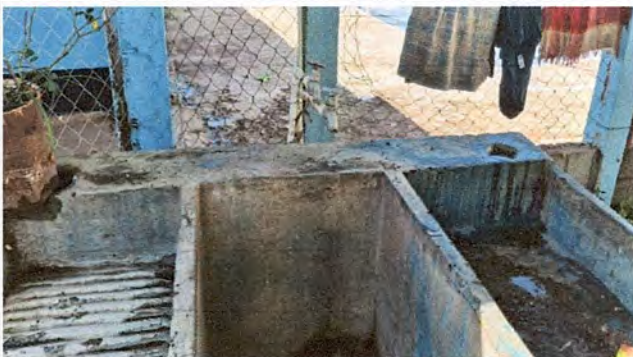
Foto 3: Lavamanos en mal estado
