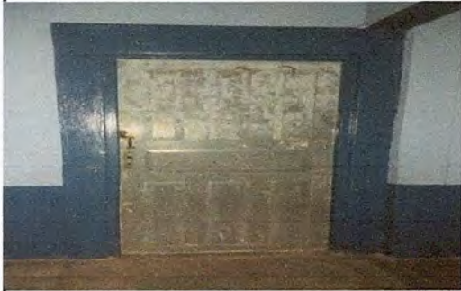
Foto 7: Puerta de madera en mal estado
