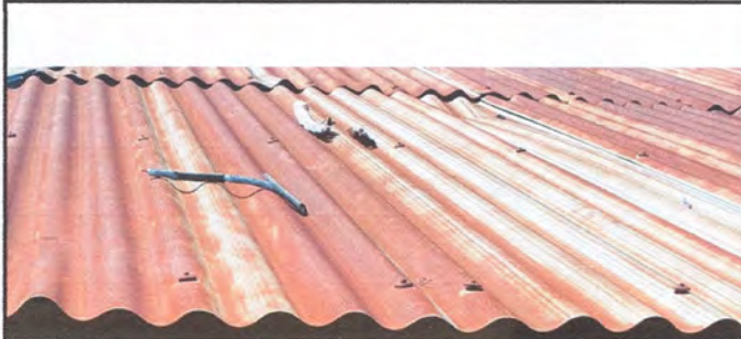
Foto1: Lámina en mal estado
