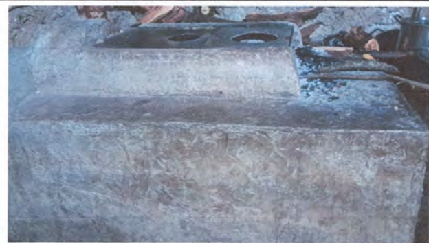
Foto 6: Fogon de cocina deteriorado
