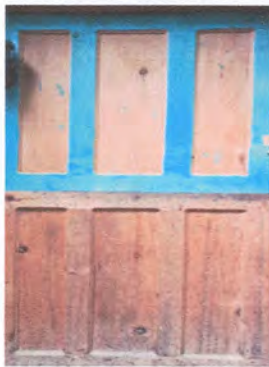
Foto 3: Puerta en mal estado
