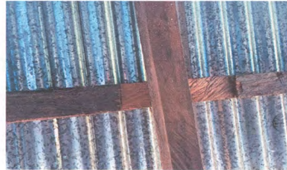
Foto 2: Soporte de madera deteriorado
