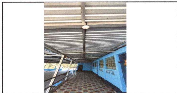
Foto 6: Accesorios de energía eléctrica instalados.
