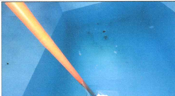
Foto 2: Sisterna funcionando correctamente.
