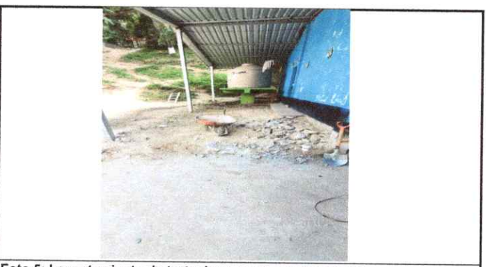
Foto 5: Levantamiento de torta de cemento en mal estado.
