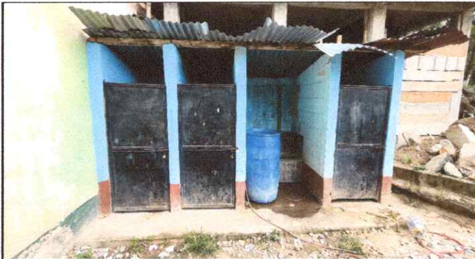
Foto 4: Falta de mantenimiento de las puertas.
