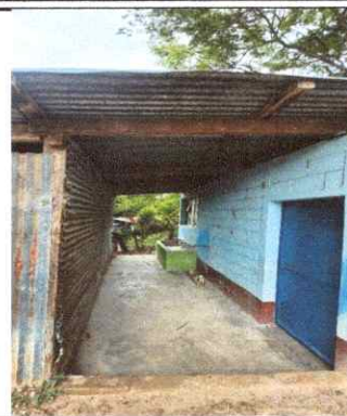
Foto 2: Soportes de madera en mal estado.
