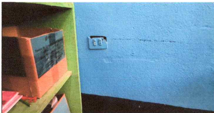
Foto 5: Toma corrientes en mal estado.
