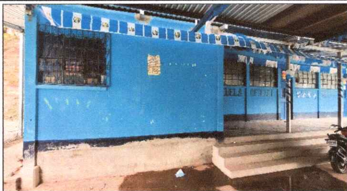
Foto 1: Pintura en mal estado.
