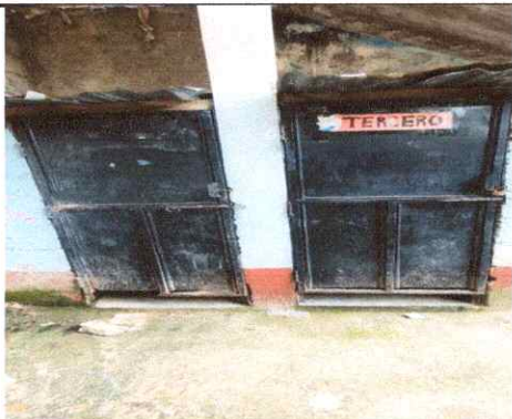
Foto 3: Puertas de metal en mal estado.
