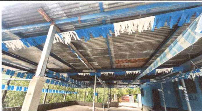
Foto 1: Mal estado de la lámina oxidada y con agujeros.
