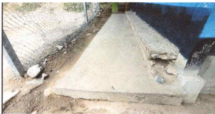
Foto 5: Torta de cemento con grietas e incompleta.
