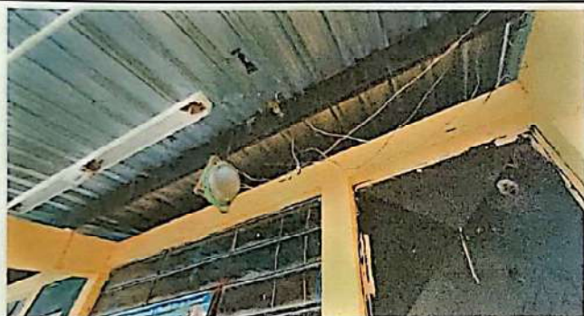
Foto 9: Instalacion electrica en mal estado y sin funcionamiento
