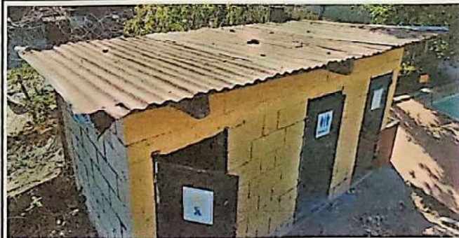
Foto 4: Entechado de los servicios sanitarios en mal estado
