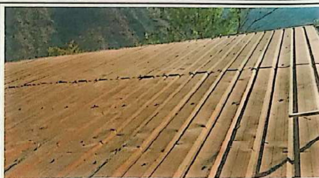
Foto 2: Lamina de la escuela en mal estado
