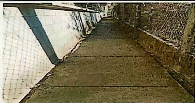
Foto 11: Grietas en el pasillo de la escuela por sismos
