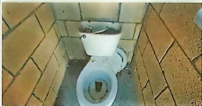
Foto 7: Tinas del servicio sanitario en mal estado
