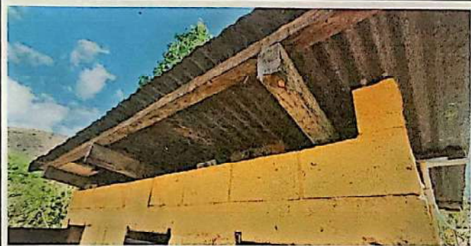
Foto 3: Entechado de los servicios sanitarios en mal estado
