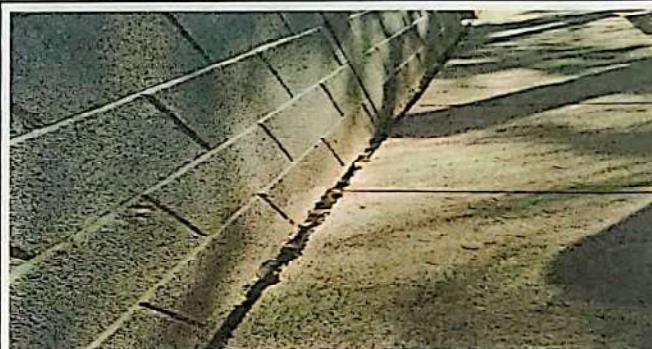
Foto 10: Grietas en el pasillo de la escuela por sismos
