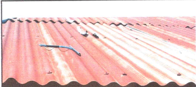
Foto 1: Lámina en mal estado
