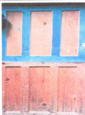
Foto 3: Puerta en mal estado
