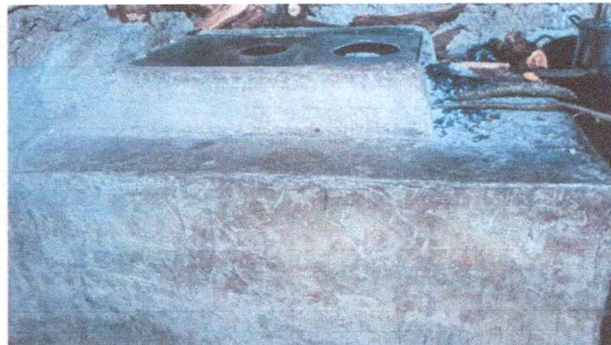
Foto 6: Fogon de cocina deteriorado
