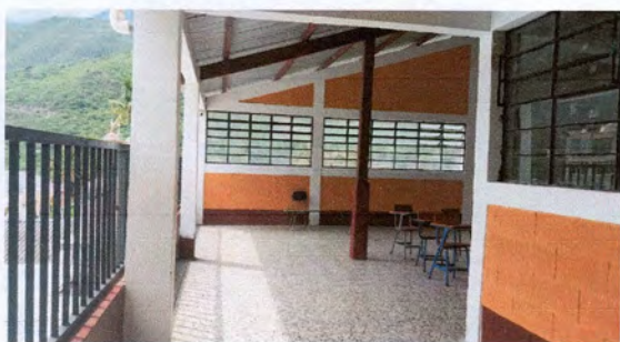
Foto 3: Aula sin puerta.
