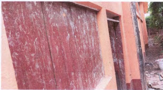
Foto 9: Las puertas y ventanas, en el área de tienda escolar; son antiguas, de madera y están deterioradas.
