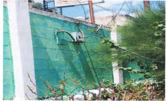
Foto 8: Tablero y flipones principales, en mal estado.
