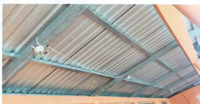
Foto 4: Tendido eléctrico en mal estado.
