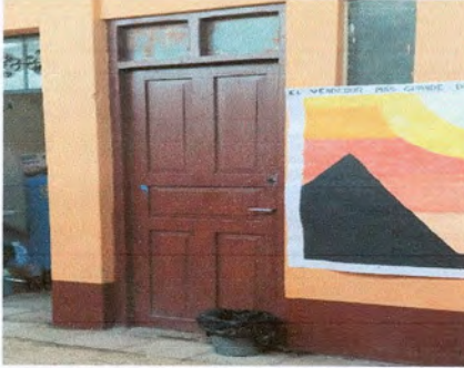
Foto 7: La puerta del servicio sanitario es antigua, de madera y está deteriorada.
