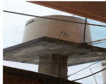
Foto 10: El depósito de agua es insuficiente para abastecer a todos los estudiantes.
