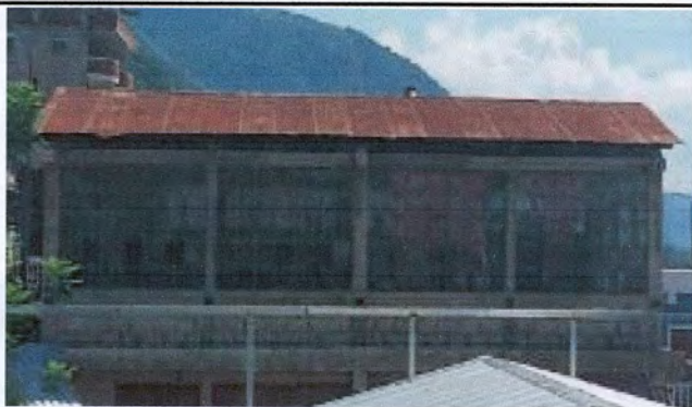
Foto 1: Techo de aula con lámina deteriorada.
