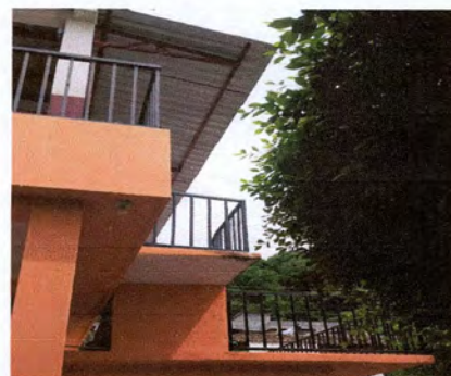
Foto 2: La cubierta de lámina no cubre el espacio completo, lo que provoca deterioro del barandal.
