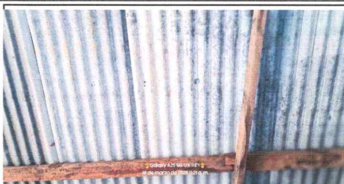
Foto 2: estructura de techo en mal estado.
