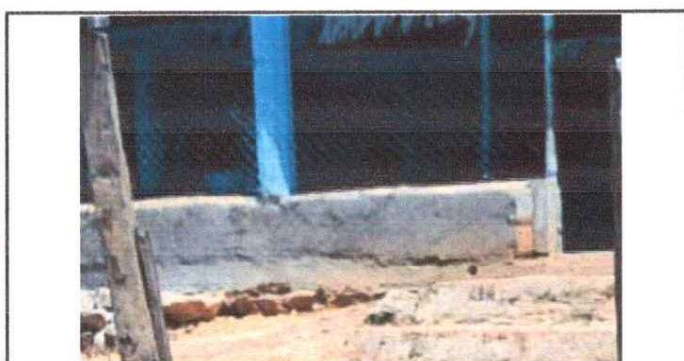
Foto 5: Circulación con malla deteriorada
