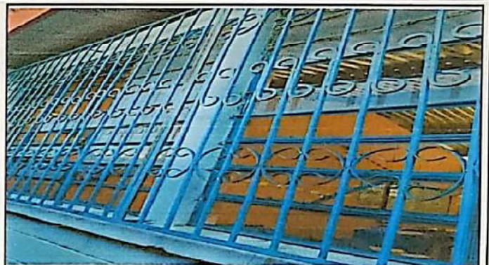
Foto 8: Sustrucción de vidrios.
