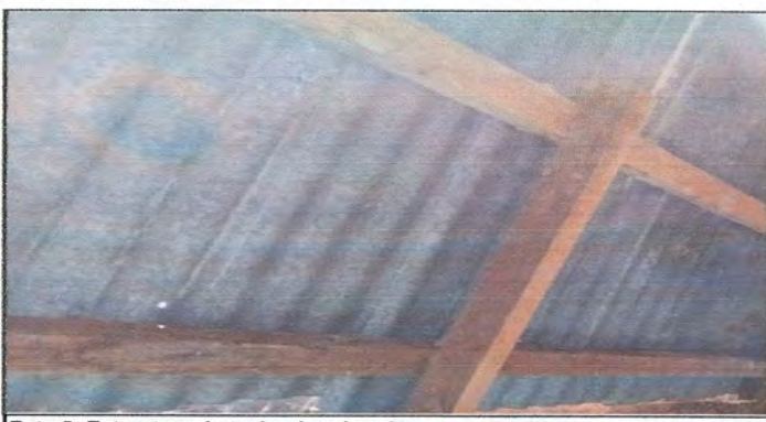
Foto 5: Estructura de techo deteriorado
