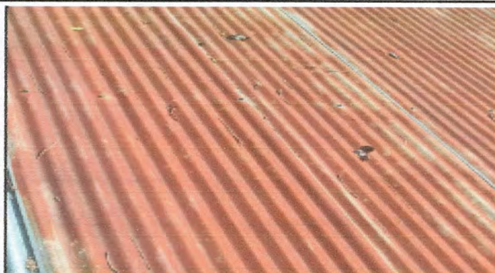
Foto 1: La lámina de la escuela lleva varios años sin cambio y ya se encuentra en mal estado
