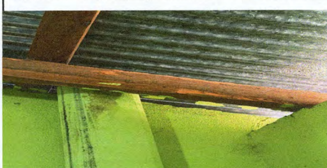
Foto 2: Madera en mal estado
