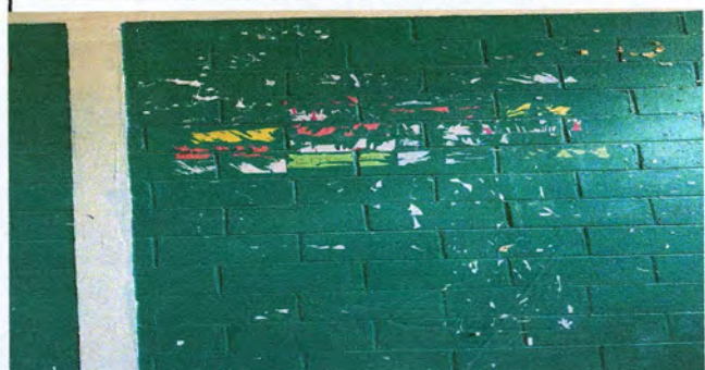
Foto 6: Pintura de pared en mal estado
