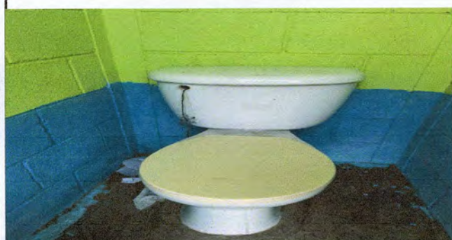
Foto 3: Acesoio de baño deteriorado
