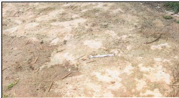
Foto 2: Piso en mal estado
