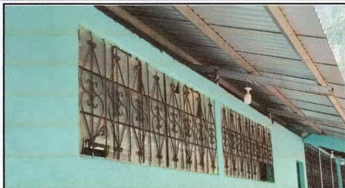
Foto1: Ventana deteriorada y vidrios rotos
