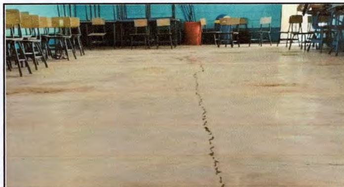
Foto 3: Piso en malas condiciones
