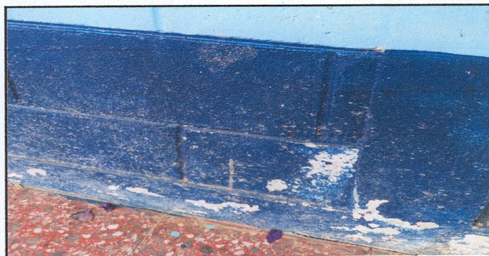
Foto 6: Pintura en malas condiciones
