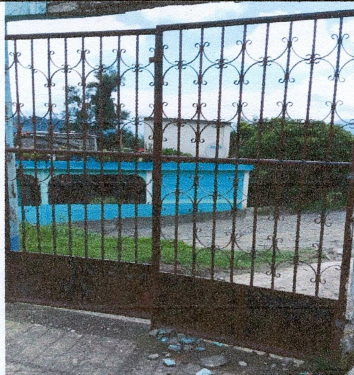
Foto 1: Lámina en mal estado
