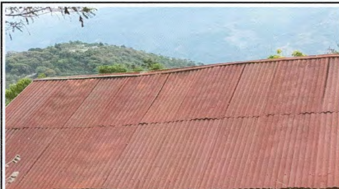
Foto1: Lamina en mal estado
