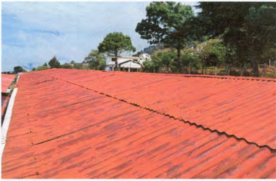
Foto1: Cubierta de lámina (Láminas en mal estado)
