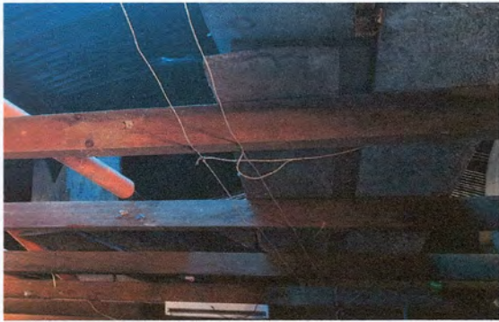
Foto 2: Estructura de techo (Madera deteriorada)
