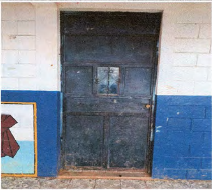
Foto 3: Puertas de metal
