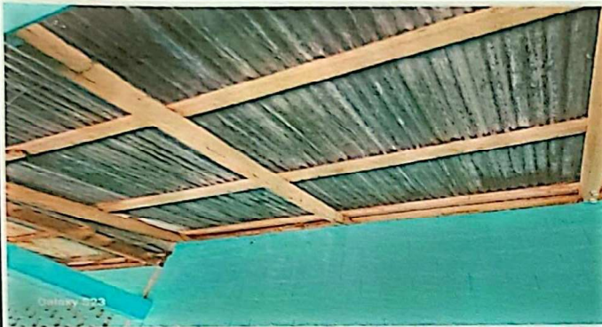
Foto 1: Estructura de soporte de madera en mal estado.
