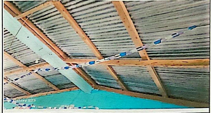
Foto 2: Toda la estructura de soporte de madera se encuentra en mal estado.
