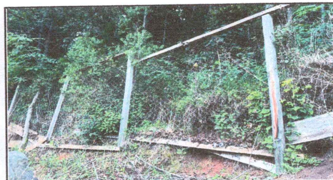
Foto 6: Circulación del predio escolar deteriorado.
