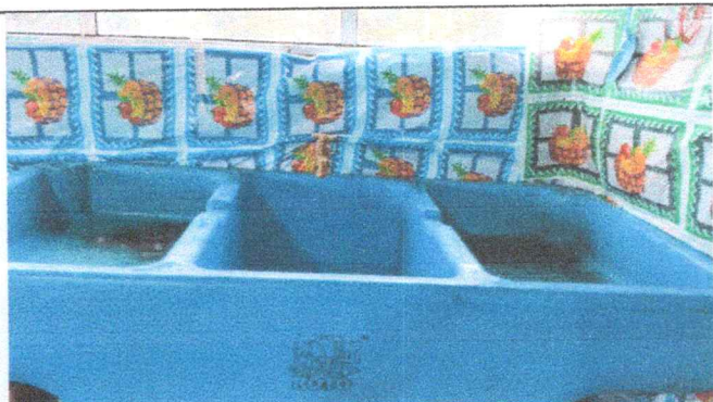
Foto9: Pila en mal estado
