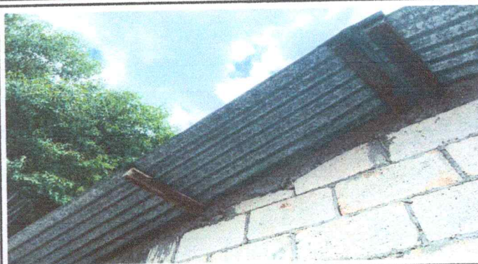
Foto 2: Estructura de techo deteriorado.
