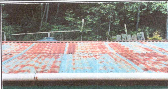
Foto 1: Lámina en mal estado.
