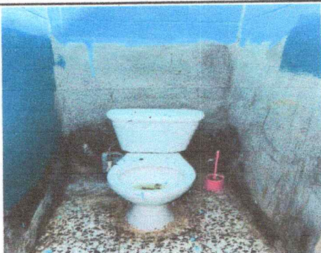
Foto7: Inodoro en mal estado
