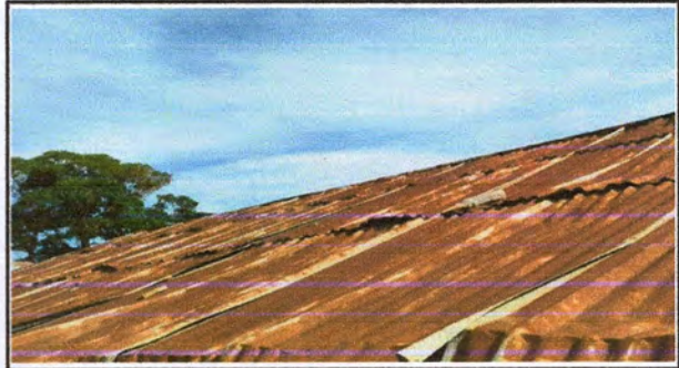
Foto 2: lámina en mal estado
