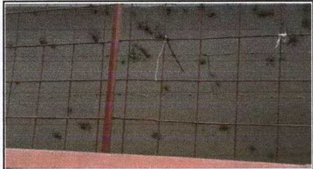
Foto 4: Balcon de metal deteriorado
