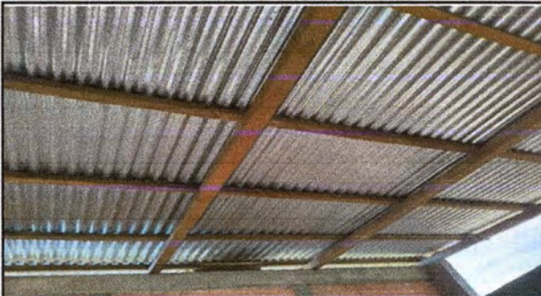
Foto 3: ESTRUCTURA DE TECHO DE MADERA DETERIORADA
