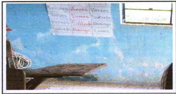
Foto 6: Pintura en mal estado
