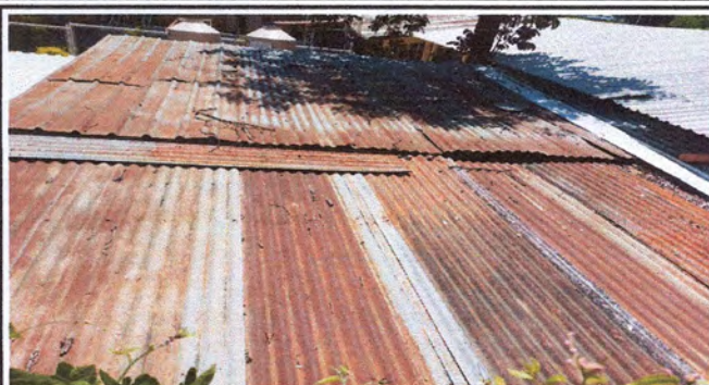
FOTO 1: CUBIERTA DE LÁMINA CON AGUJEROS.
