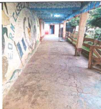
Foto 3: Piso en mal estado
