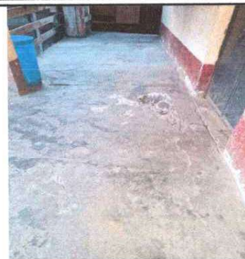
Foto 2: Piso en malas condiciones
